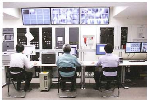
防災センターの総合管理システム
